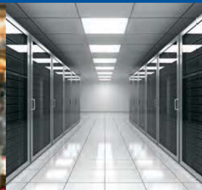
Gabinetes de servidor em data centers
